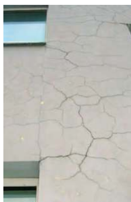
Рис. 16а. Трещины на штукатурке, затворенной избытком воды
