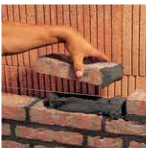
1. Укладка камня на высокопластичном кладочном растворе V.O.R. с полной заливкой швов, выпускаемом фирмой "Квик-микс". Прочное сцепление раствора с кирпичом.
