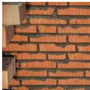
Выдавливаемый раствор не обрывается. Никаких загрязнений остатками раствора на лицевой стороне кирпича. Крепление каменной кладки и вентиляционные щели не замазаны раствором.
